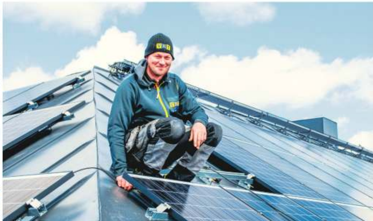
Andreas Bergdahl på VHT Byggplåt är van att arbeta på hög höjd men att montera solpaneler i den här omfattningen är helt nytt.
